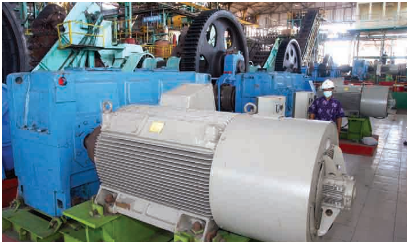
■ MANAJER Instalasi PG Kremboong, Santoso menunjukkan elektromotor yang dipasang di stasiun gilingan.
